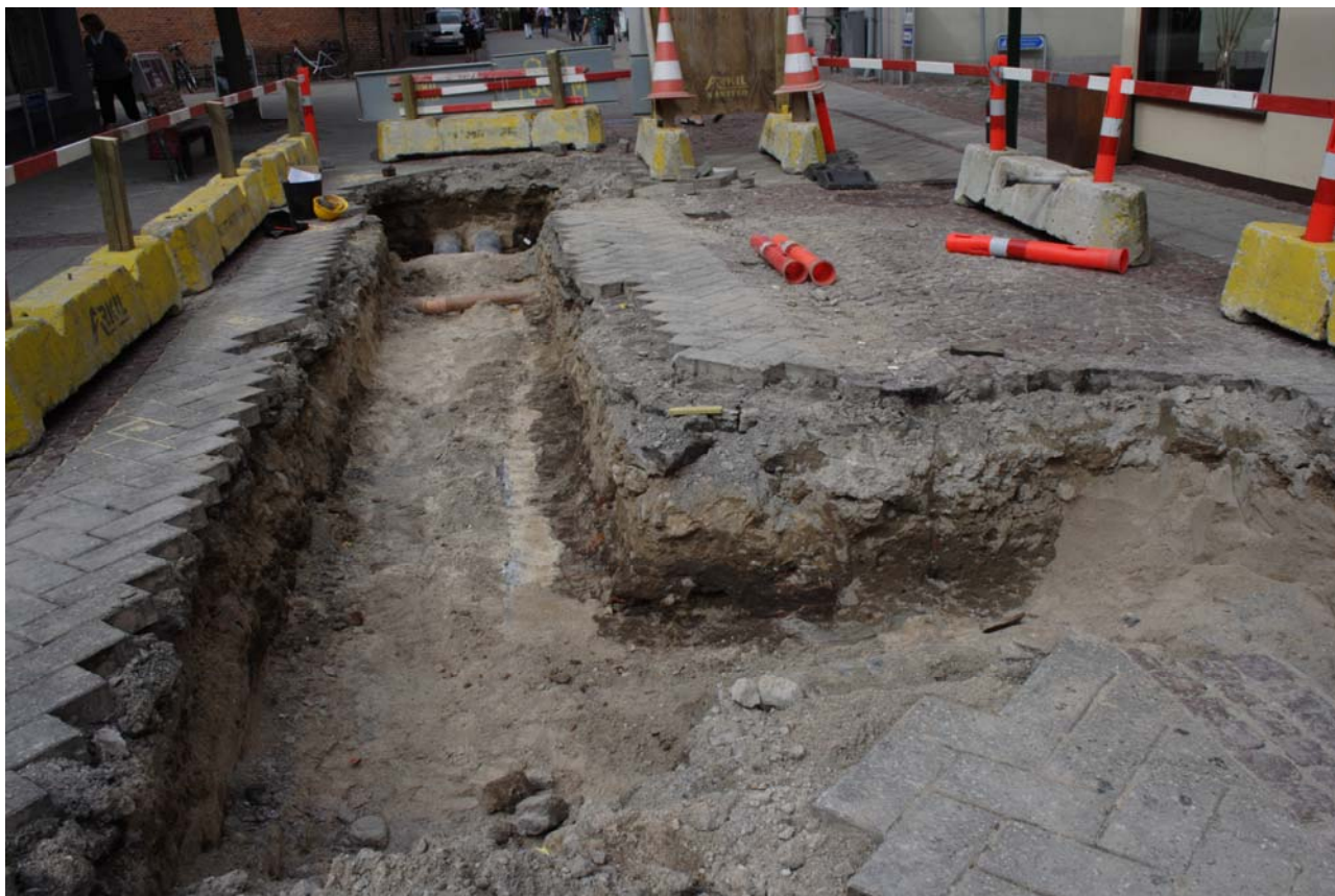
Fig. 1. Der gøres klar til opgravning af fjernvarmerør ved Nygade. Set fra øst.
